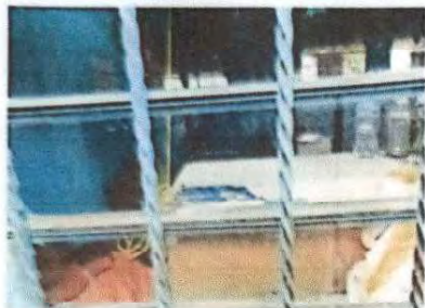
Foto 7: Sustrucción de vidrios de ventanales del módulo 2 al frente y atrás
