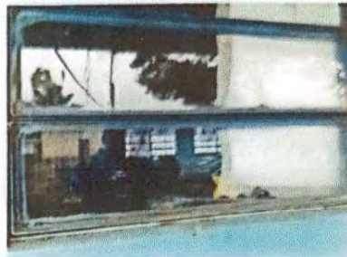
Foto 8: Sustrucción de vidrios de ventanales del módulo 2 al frente y atrás
